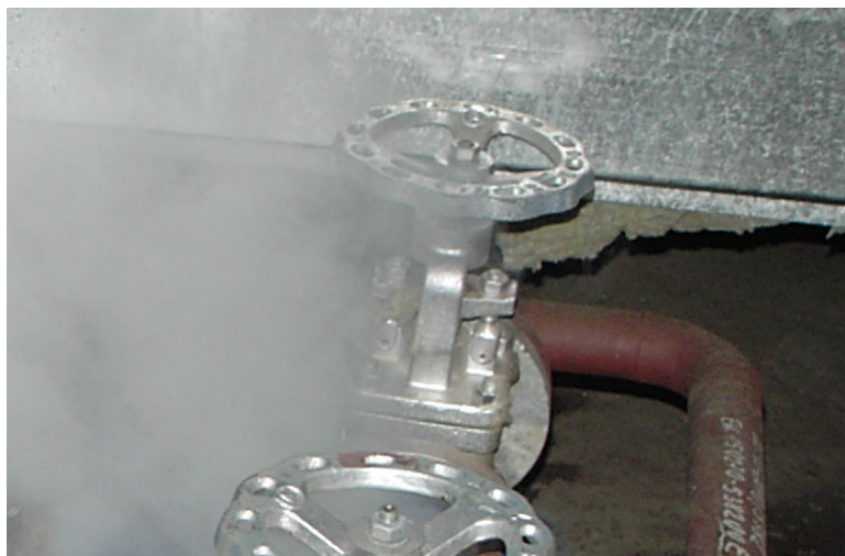
Rysunek 1. Miejsca przecieków w instalacji pary i kondensatu to potencjalne punkty wnikania powietrza
