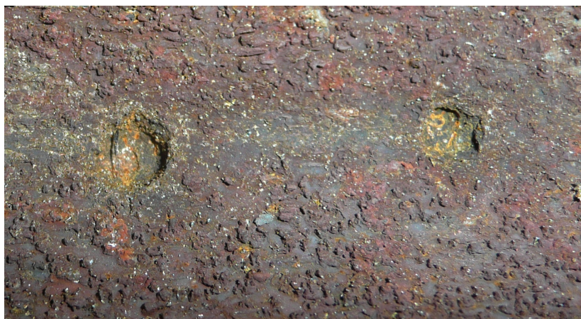
Rysunek 6. Wżery korozji tlenowej na ściankach rurociągu kondensatu
